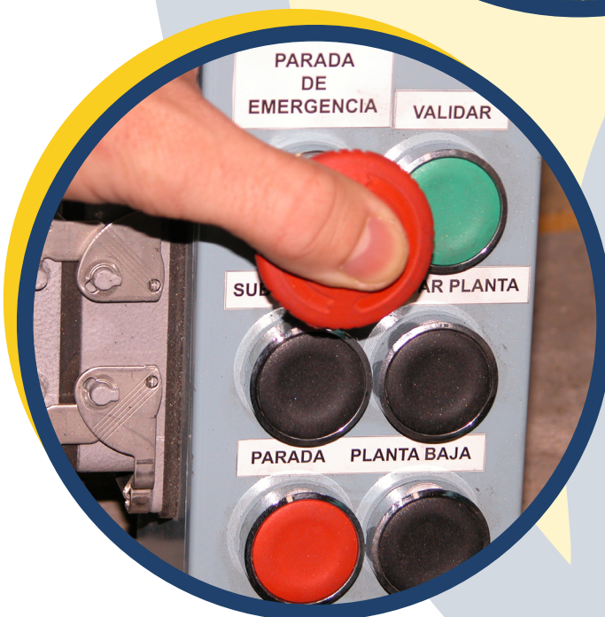
Dispositivo di arresto di emergenza su un montacarichi.
